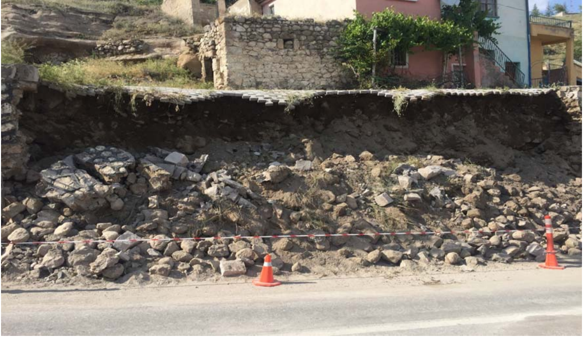
Güzelyurt İlçesi Ihlara Belediyesi yağışlardan zarar gören kamu tesisleri tespit çalışmaları
