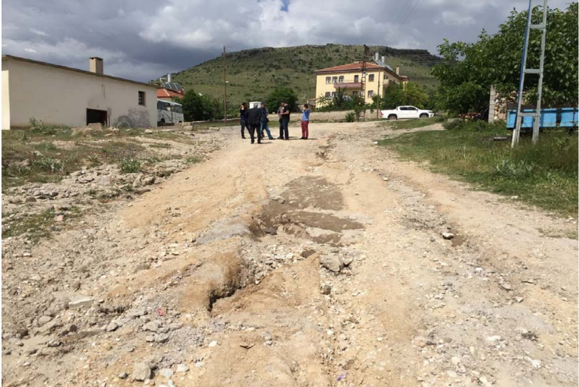
Güzelyurt İlçesi selden zarar gören kamu tesisleri tespit çalışmaları
